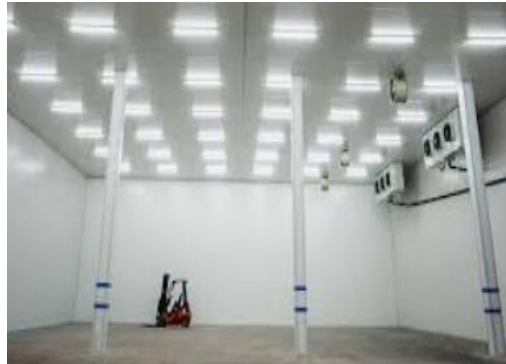
FIGURA 59.- FUENTE WEB: CÁMARA DE CONSERVACION DE PRODUCTO TERMINADO (4°C)
