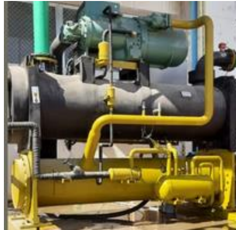
FIGURA 67.- FUENTE: WEB- SISTEMA DE FRIO (CHILLER).
