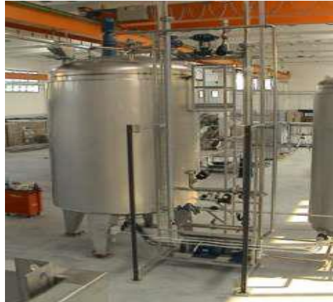
FIGURA 43.- FUENTE: TANQUE DE MEZCLA CON AGITADOR VERTICAL SIROPE
