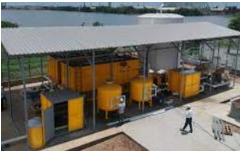
FIGURA 69.- FUENTE: WEB- PLANTA DE TRATAMIENTO DE AGUAS RESIDUALES
