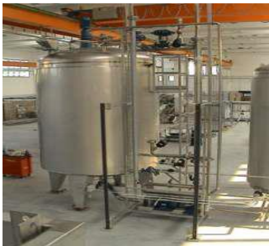
FIGURA 33.- FUENTE: TANQUE DE FORMULACION
