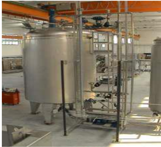
FIGURA 30.- FUENTE: TANQUE DE MEZCLA CON AGITADOR VERTICAL SIROPE
